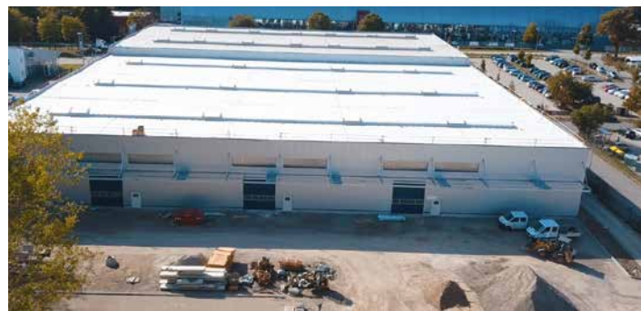
Die Yamaton Paper GmbH realisierte in 2018 erfolgreich einen Standortwechsel der gesamten Produktionsstätte inklusive der Administration vom Ölhafen in die Schutower Straße. Das Foto zeigt den Baufortschritt des Teilneubaus von 10/2018. Der Umzug erfolgte wie geplant zum Jahreswechsel.
